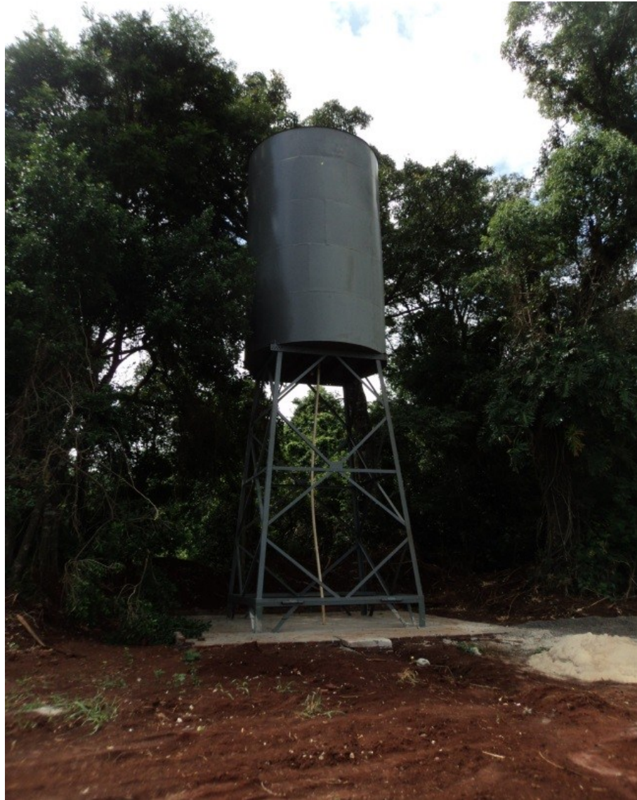
Figura 89 – Reservatório Sede II
