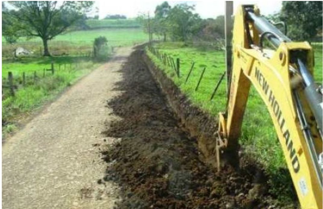
Figura 101 – Rede de Abastecimento
