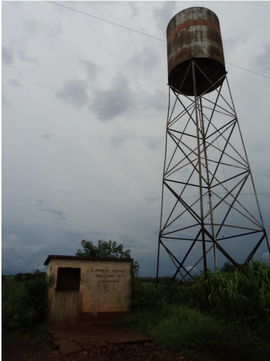
Figura 97 – Reservatório Distritos Taipão Frente e Taipão Fundo
