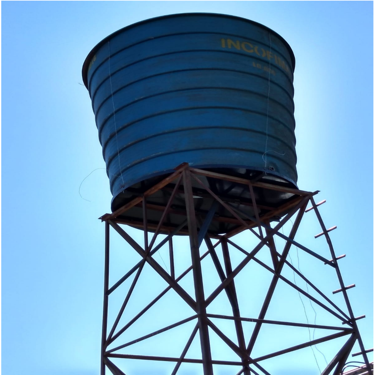
Figura 95 – Reservatório Distrito Santa Terezinha
