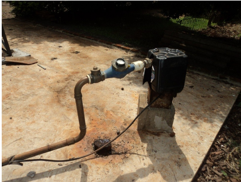
Figura 68 – Poço SEDE 2 - Rua 1º de Maio
