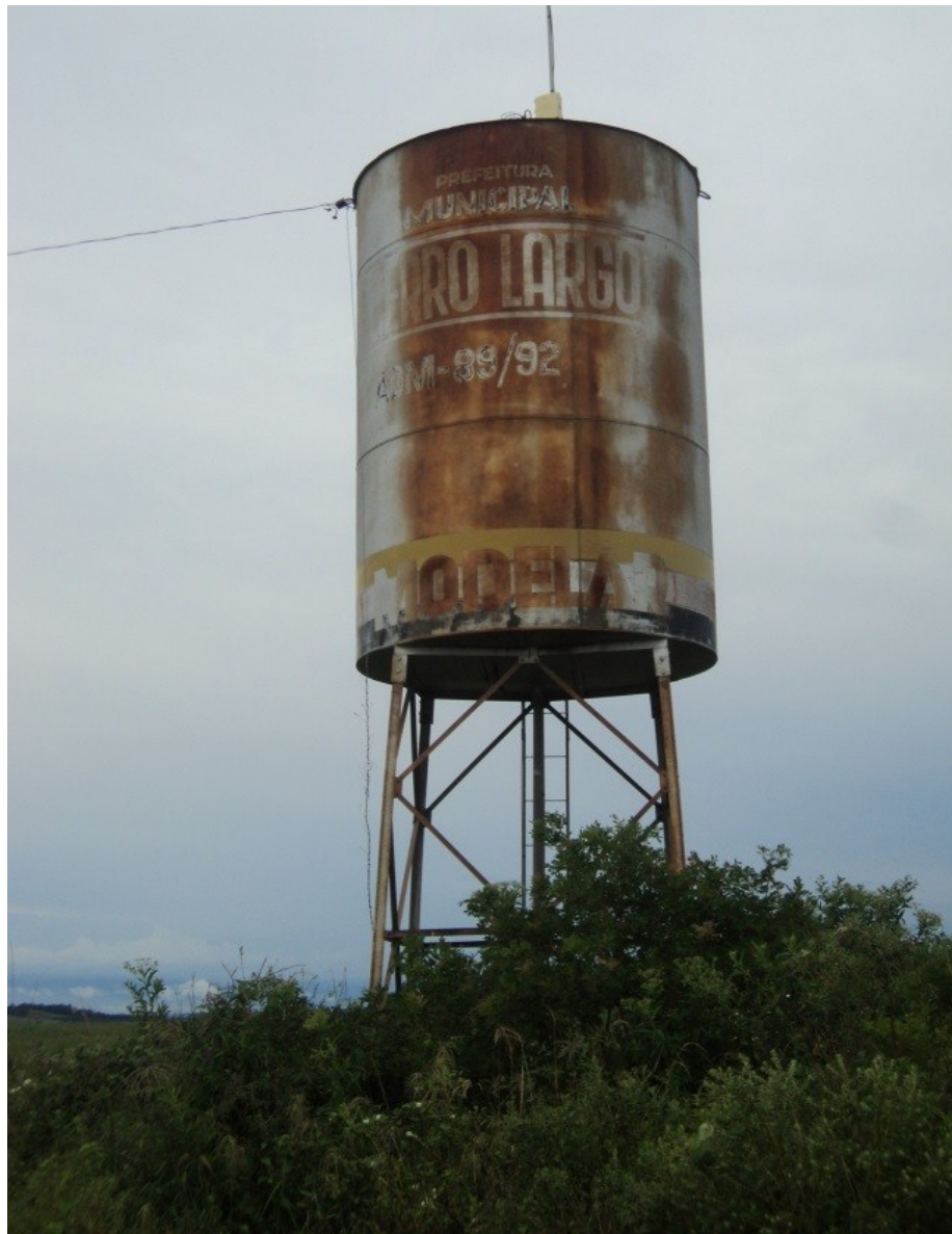
Figura 98 – Reservatório Distritos Taipão Frente e Taipão Fundo
