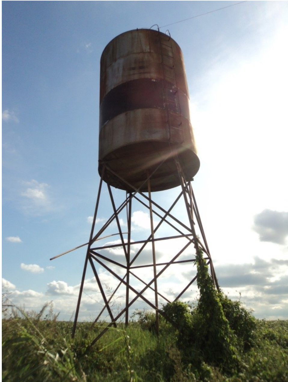
Figura 93 – Reservatório Distrito Boa Esperança
