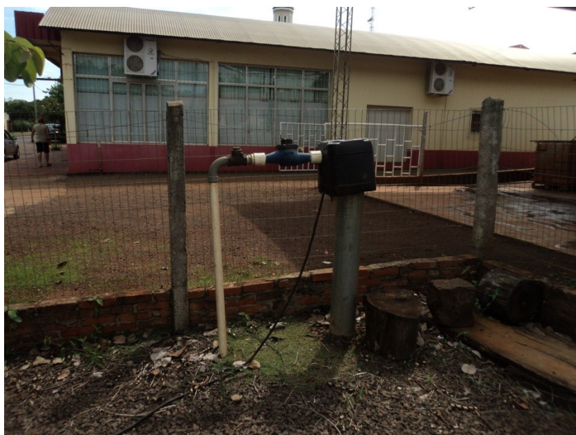
Figura 69 – Poço SEDE 3 - Rua Roque Gonzales
