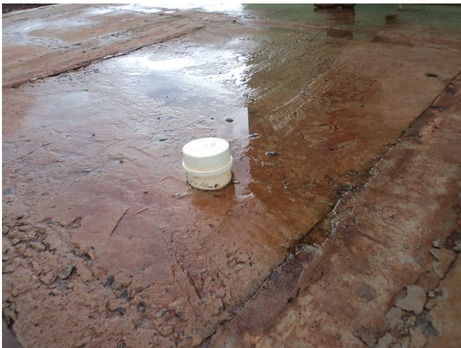
Figura 114 – Fossa Séptica encontrada no perímetro urbano
