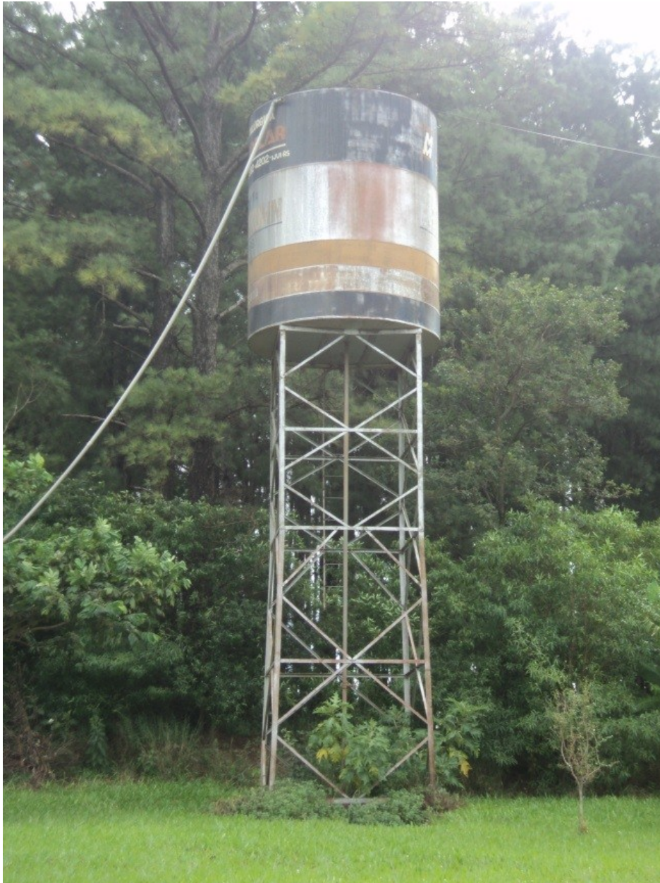
Figura 100 – Reservatório Distrito Linha Bonita Norte
