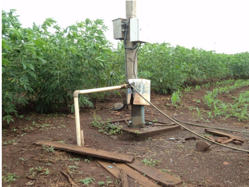
Figura 82 – Poço Taipão Frente
