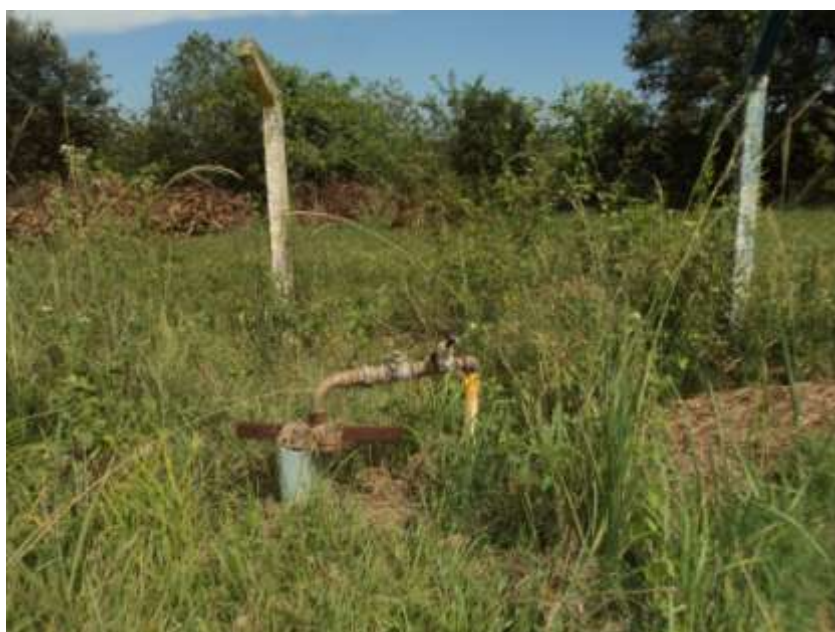
Figura 71 – Poço SEDE 5 – Parque Municipal
