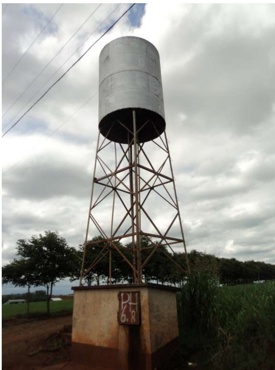
Figura 90 – Reservatório Distrito Butiá Inferior Sul
