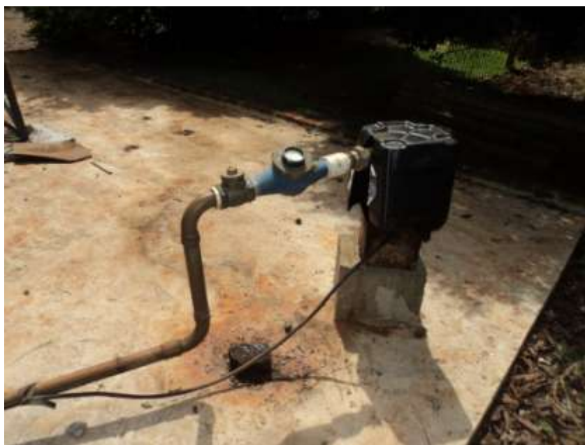
Figura 68 – Poço SEDE 2 - Rua 1º de Maio
