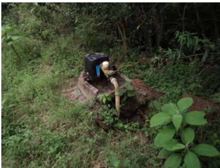
Figura 75 – Poço Butiá Inferior Centro
