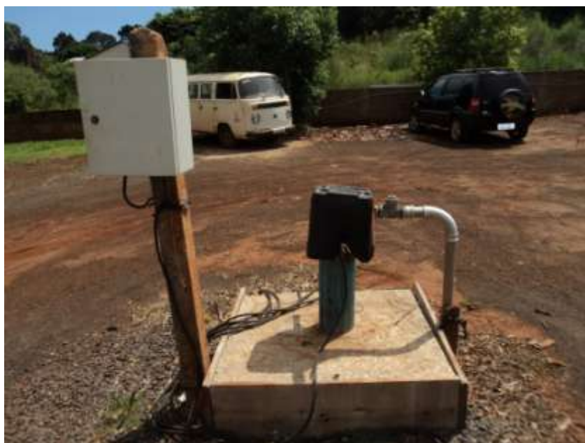
Figura 67 – Poço SEDE 1 - Prefeitura
