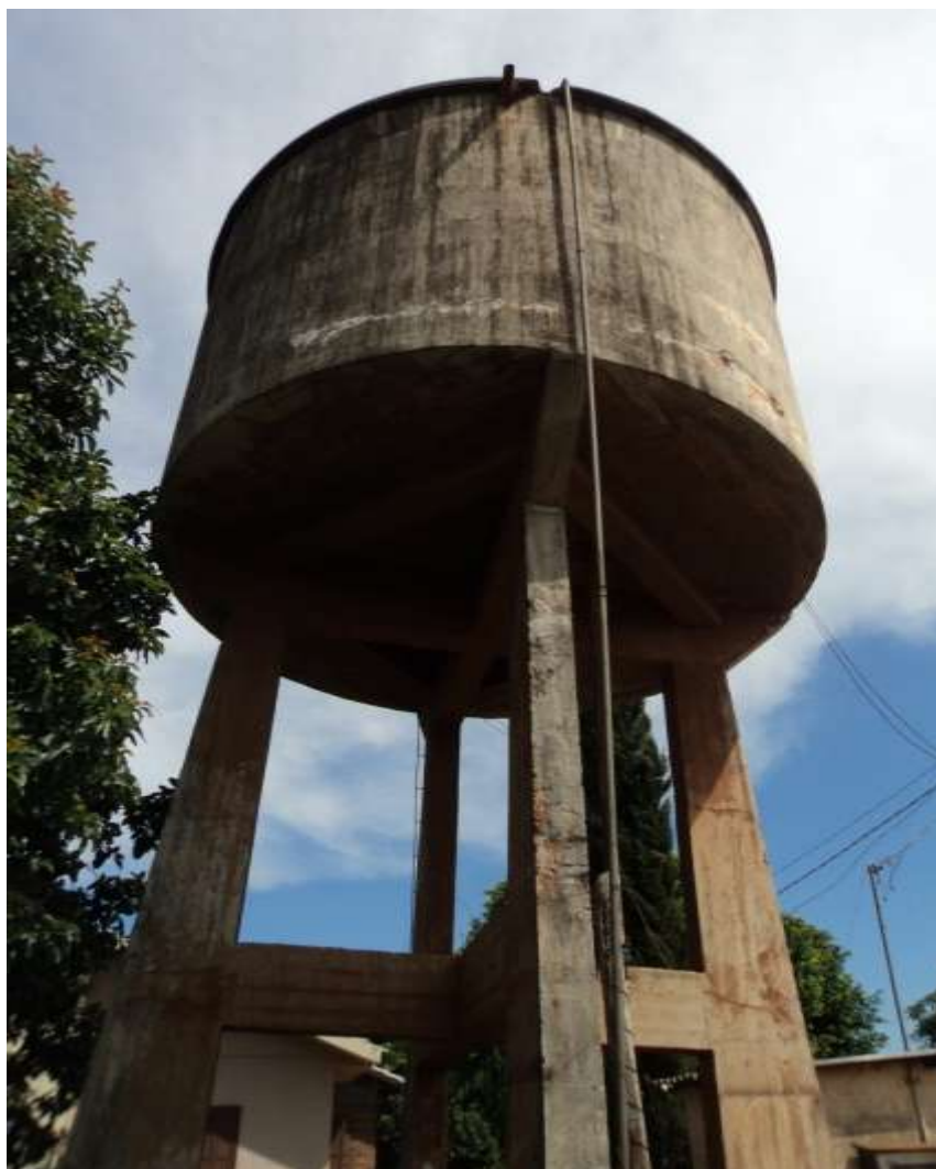
Figura 88 – Reservatório Sede I
