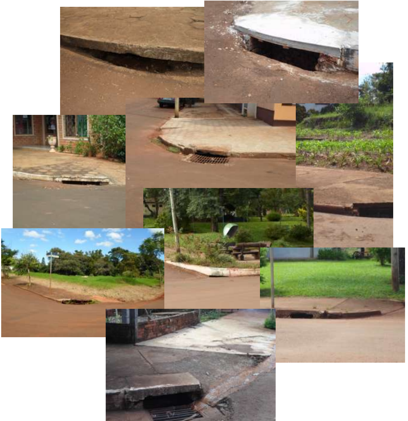
Figura 123 – Bocas de Lobo – Perímetro Urbano
