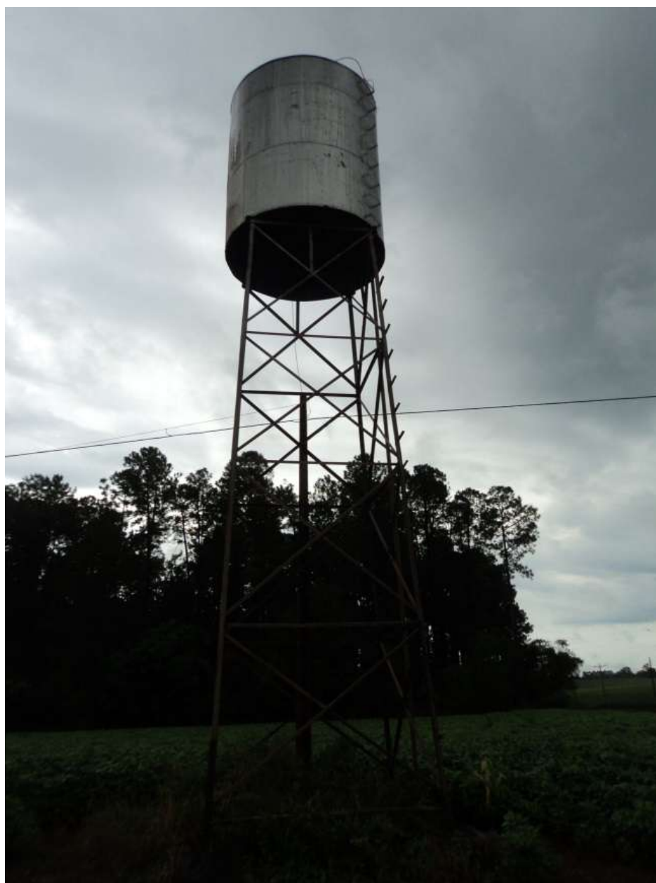
Figura 94 – Reservatório Distrito Esquina União
