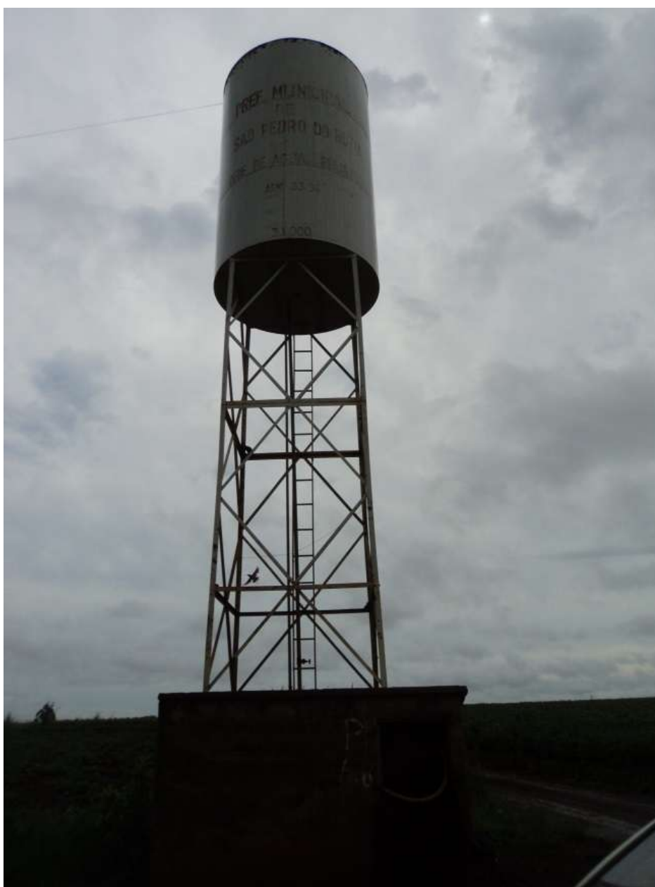
Figura 96 – Reservatório Distrito Beija-Flor
