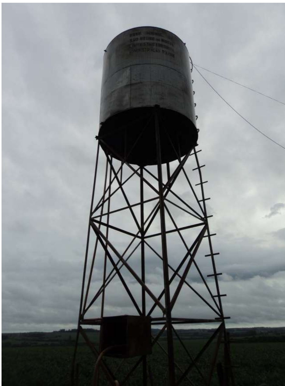
Figura 95 – Reservatório Distrito Santa Teresinha
