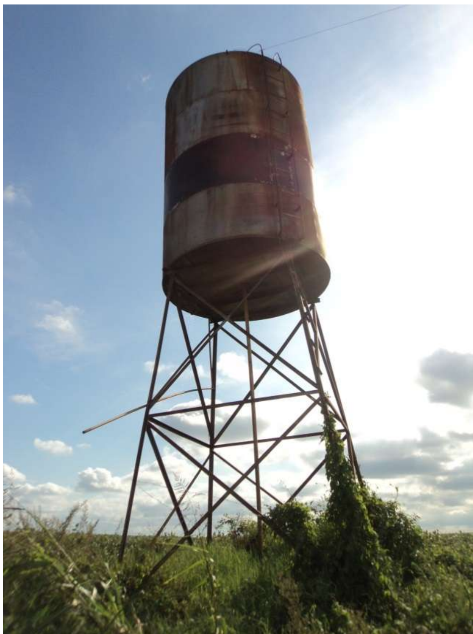
Figura 93 – Reservatório Distrito Boa Esperança
