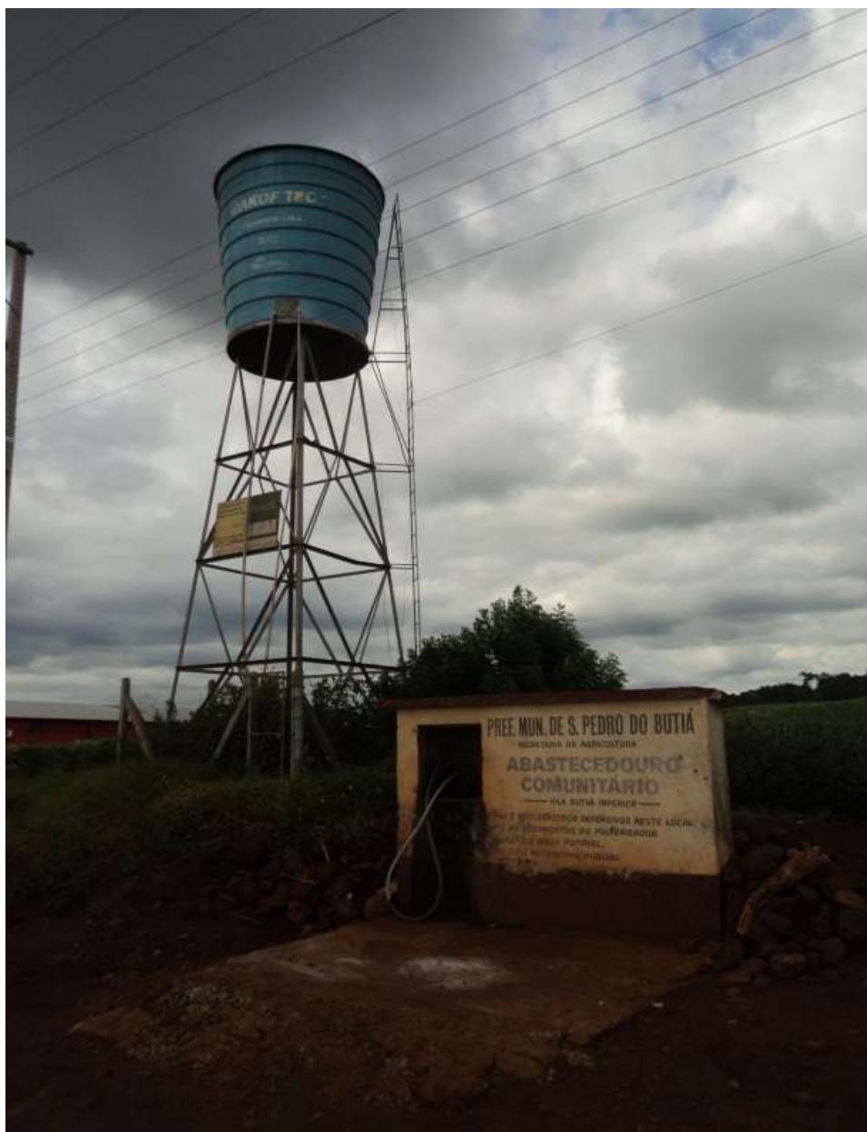
Figura 92 – Reservatório Distrito Butiá Inferior Norte
