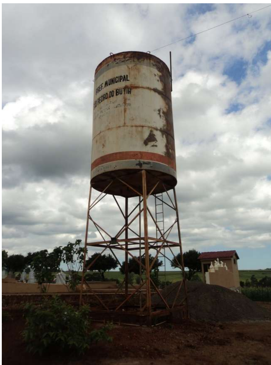
Figura 91 – Reservatório Distrito Butiá Inferior Centro
